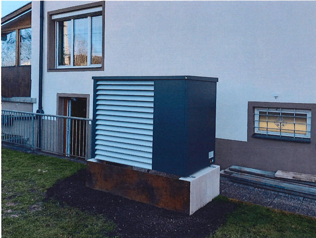
Foto 1: Aufstellung an der Fassade, auf Betonsockel montiert
