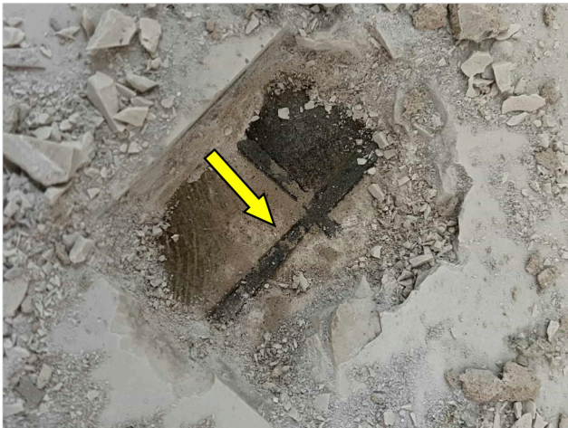
OG, Dusche (Detail Boden) Bodenfliesen weisslich gross (nach 1990): kein Asbestverdacht darunter PK4: Fliesenkleber Boden w/g, asbesthaltig
