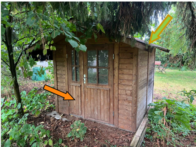
Holzschopf im Garten Dachpappe rot bituminös baugleich DP1: kein Asbest, kein PAK-Hinweis kein Fensterkitt feststellbar Aussenholz: probl. Holzabfälle
