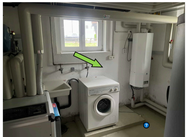
UG, Waschen/Heizung VP3: Wandverputz Waschen/Heizung, kein Asbest Farbanstrich Boden: PCB-Verdacht (<20 m²) Heizung/Boiler inkl. Rohrleitungen (2008/2009), Betondecke, Installationen für Schwimmbad (ca. 2008-2011): kein Asbestverdacht
