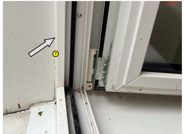
UG, Hobby (Detail Fenster) Fenster (nach 1990): kein Asbestverdacht Fensterzarge nicht vollständig einsehbar (EPS-Isolation): Asbestverdacht (Anschlagkitt)
