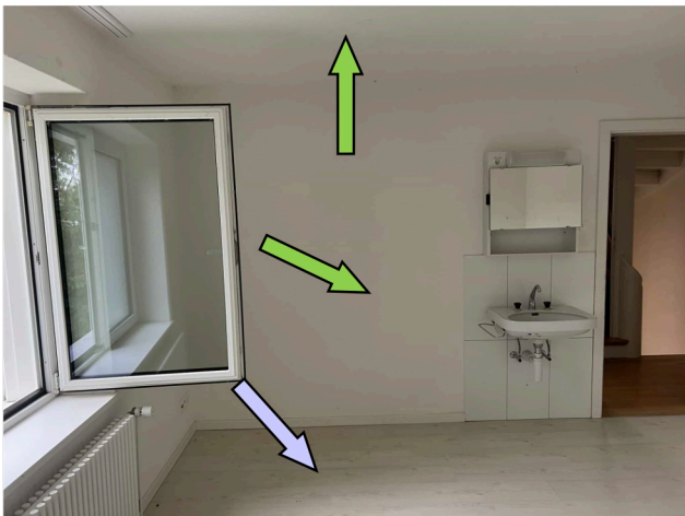
OG, Zimmer 1 (exemplarisch) VP11-2: Wandverputz Zimmer, kein Asbest VP12: Deckenverputz Zimmer, kein Asbest Wandfliesen weiss gross (nach 1990), Laminat, darunter Holzboden: kein Asbestverdacht darunter Zwischenbodenschlacke baugleich S1: PAK- und SM-haltig
