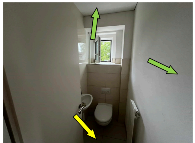
EG, WC Bodenfliesen beige (nach 1990): kein Asbestverdacht darunter Bodenfliesen w/g baugleich PK4: asbesthaltig Wand- und Deckenverputz Nasszellen baugleich VP9/VP10: kein Asbest
