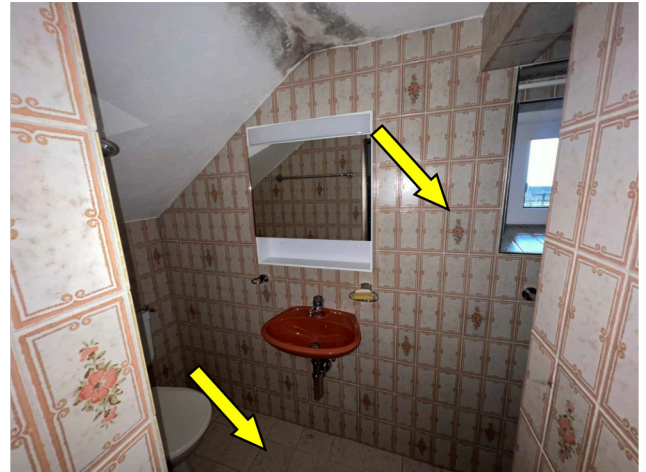
UG, Dusche PK1: Fliesenkleber Wand rosa, asbesthaltig PK2: Fliesenkleber Boden beige, asbesthaltig Betonwände, -boden und gestrichene Betondecke: kein Asbestverdacht
